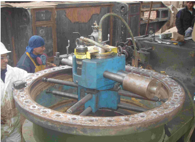
Refrentadora instalada Fuente: P8093445.JPG
